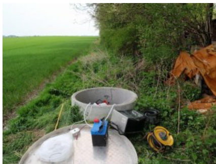
Overvågningsboringerne 198.707 og 198.708 (findes i samme brøndring)
