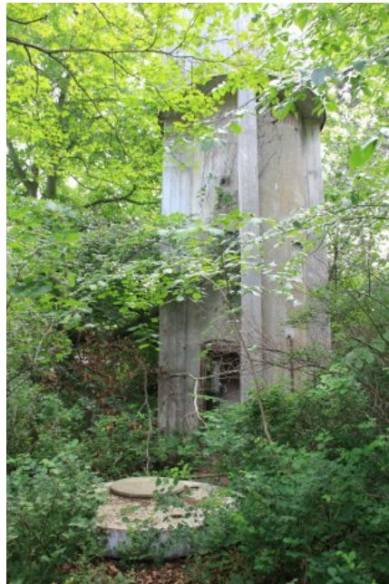
Skolehjemmet Orøstrand Vandværks boring og gamle vandtårn.
